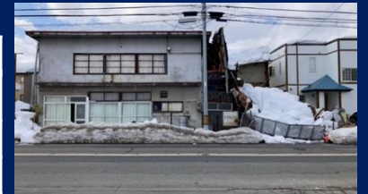
空家倒壊（米沢市）
