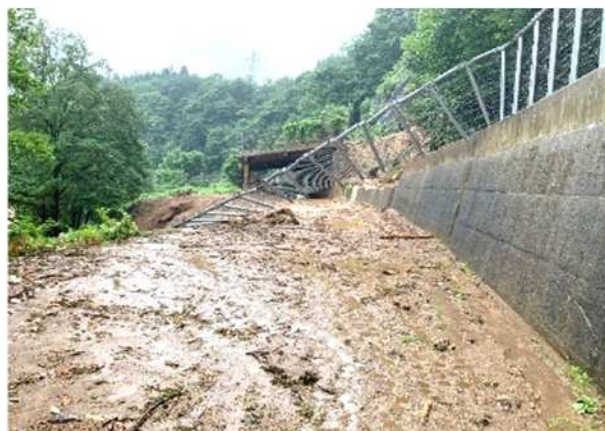
一般国道344号 道路法面崩落（真室川町）
