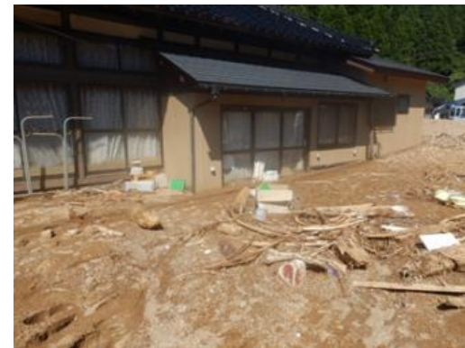
小屋渚川氾濫・住宅損壊状況（酒田市北青沢）
