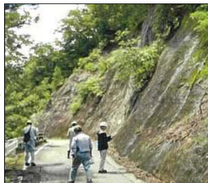
現地にて変状部を効率的に点検
