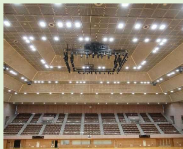
照明設備(R3完了)
