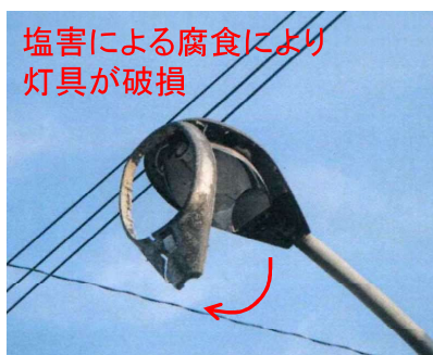
照明灯更新前
