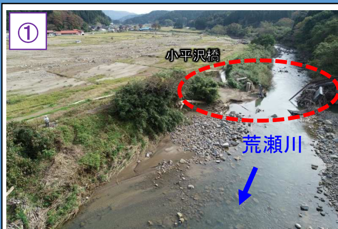
こびらさわ ▲ 荒瀬川_小平沢橋の落橋状況
