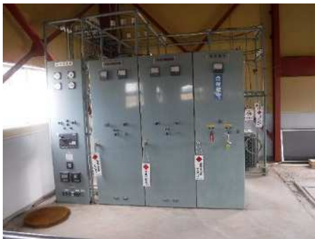
老朽化した操作盤
