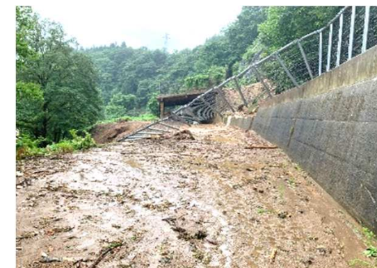
一般国道344号 道路法面崩落（真室川町）
