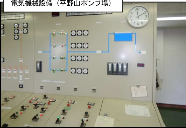
電気機械設備（平野山ポンプ場）
