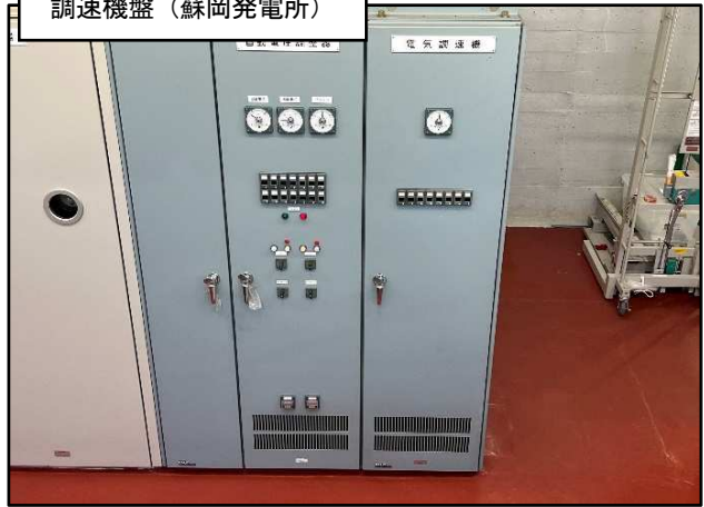
調速機盤（蘇岡発電所）
