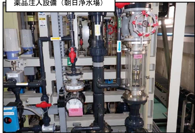
薬品注入設備（朝日浄水場）
