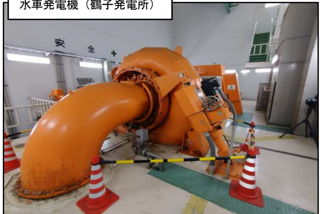
水車発電機（鶴子発電所）
