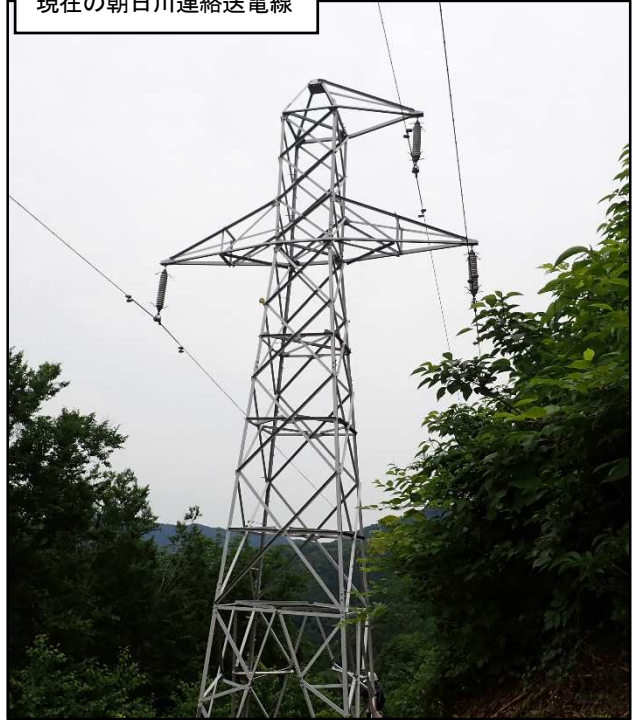
現在の朝日川連絡送電線
