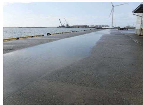
西ふ頭の舗装沈下状況
