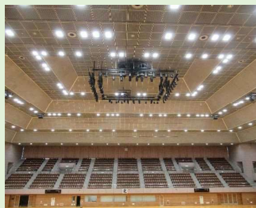
照明設備(R3完了)
