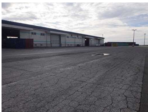
改良前（ひび割れ）
