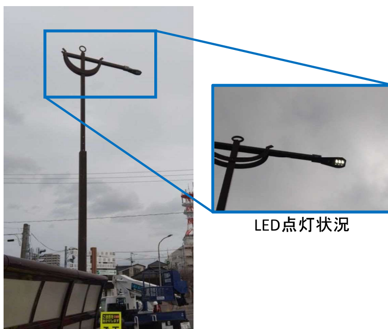
照明灯更新後
