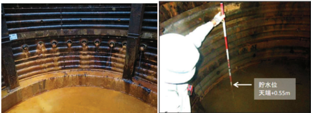
写真 2 地すべり防止区域の施設損傷状況
