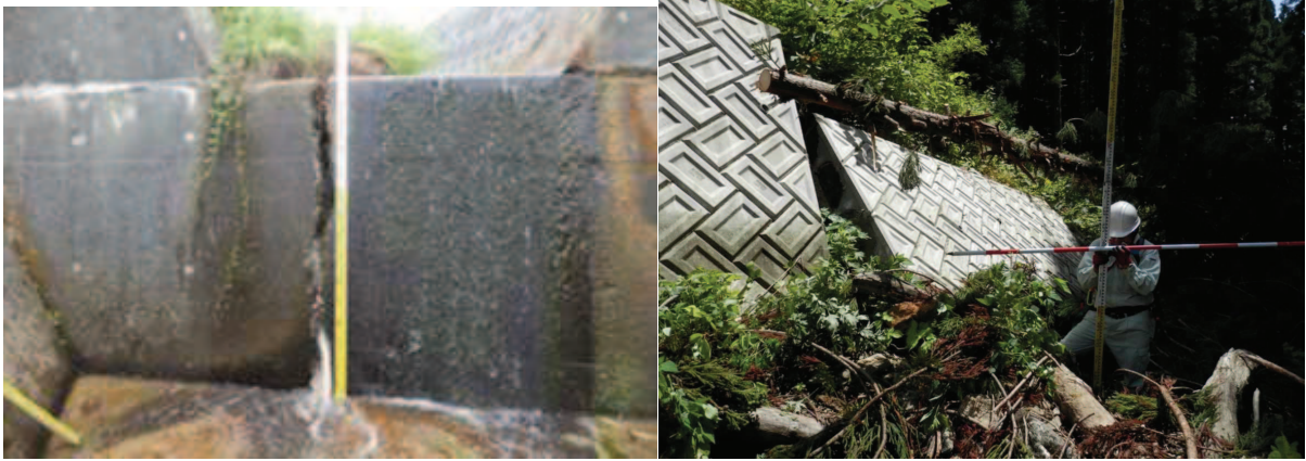
写真 1 砂防設備の損傷状況
