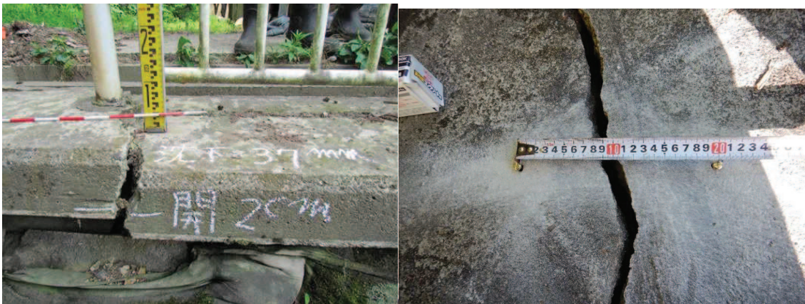
写真 3 急傾斜地崩壊危険区域の施設損傷状況
