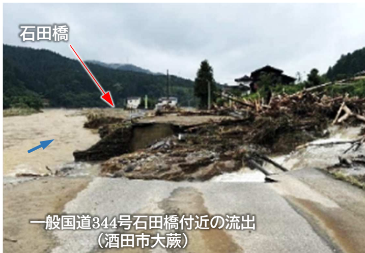
道路被害状況
