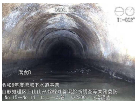
写真 2-8 山形天童幹線（腐食 B）
