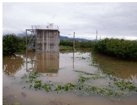
写真 2-4 大久保マンホールポンプ場 受電設備浸水状況
