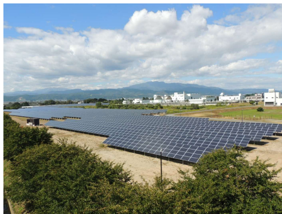
写真 2-7 山形浄化センター太陽光発電施設
