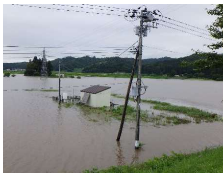
写真 2-3 横山第1マンホールポンプ場 受電設備浸水状況
