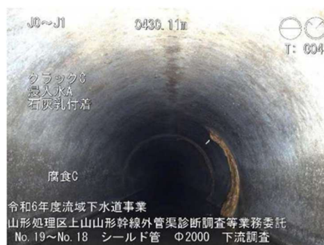
写真 2-9 山形天童幹線 (浸入水 A、石灰乳付着、腐食 C)
